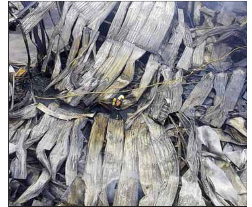
Restos de la estructura de los almacenes quemados.
