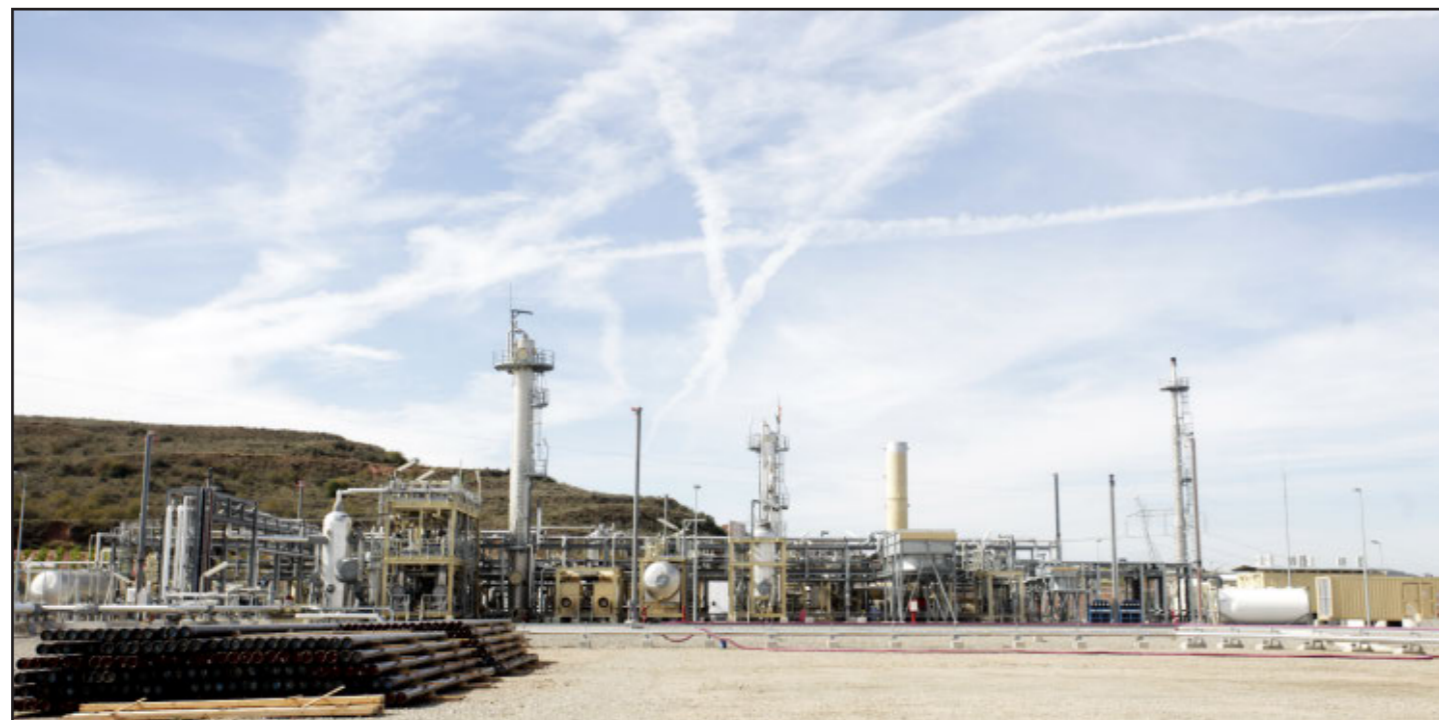
Instalaciones donde se saca el gas en terrenos del municipio de Sotés.
